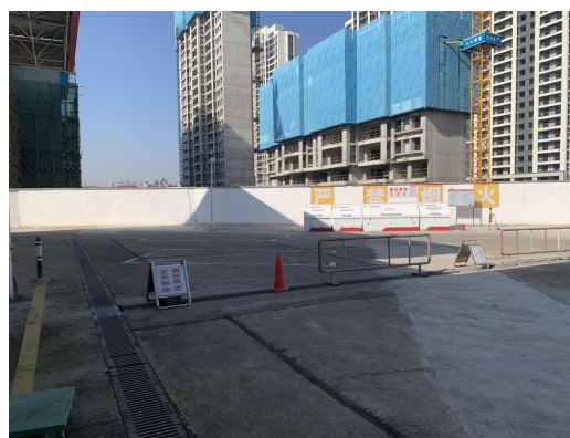
消防沙、围栏、卸油标识牌
